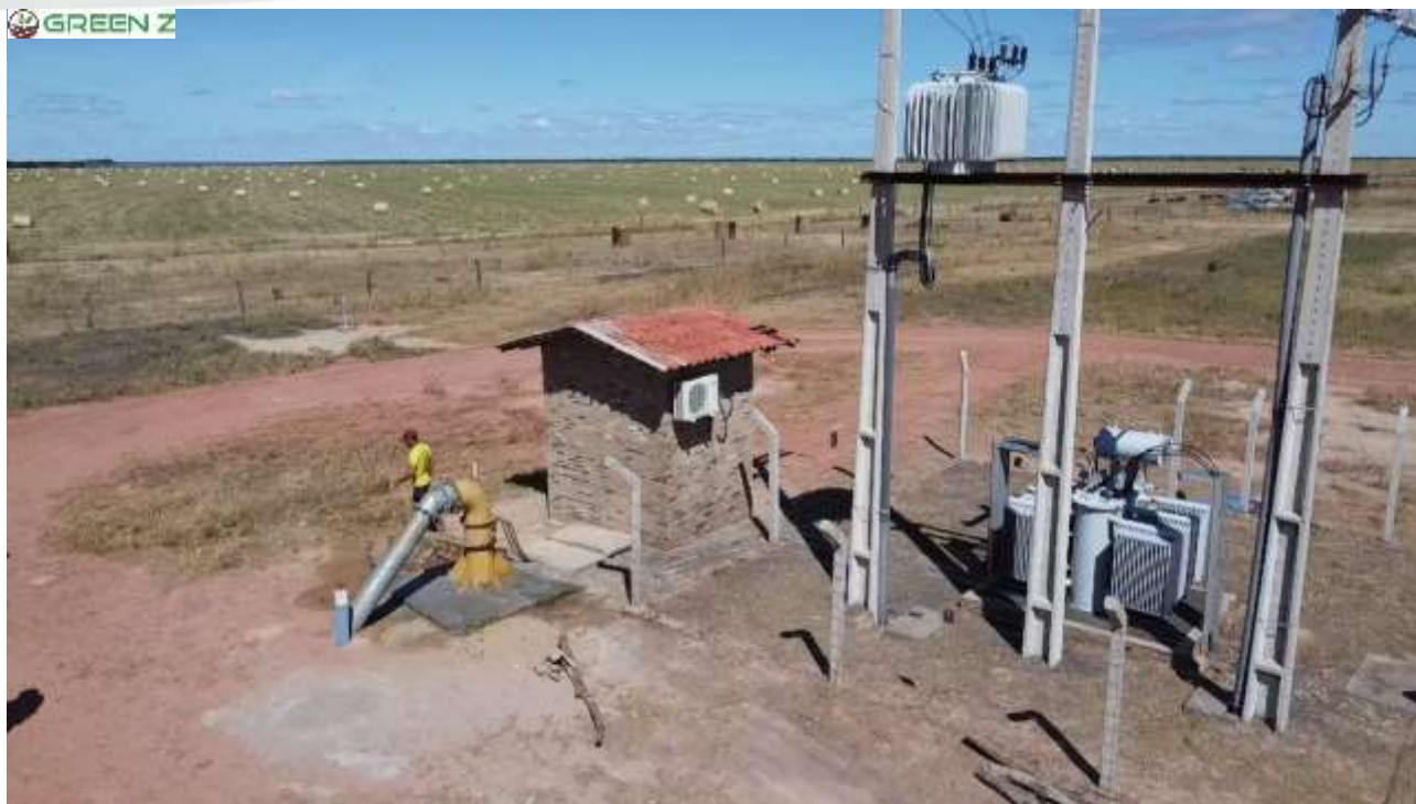
Figura 9. Estrutura para recepção e distribuição de energia elétrica para a Fazenda Vereda da Lagoa. (Coordenadas Geográficas da posição de sobrevoo da referida área com drone: -07,5418 S; -43,3517 O. Data da imagem: 15/11/2023).
