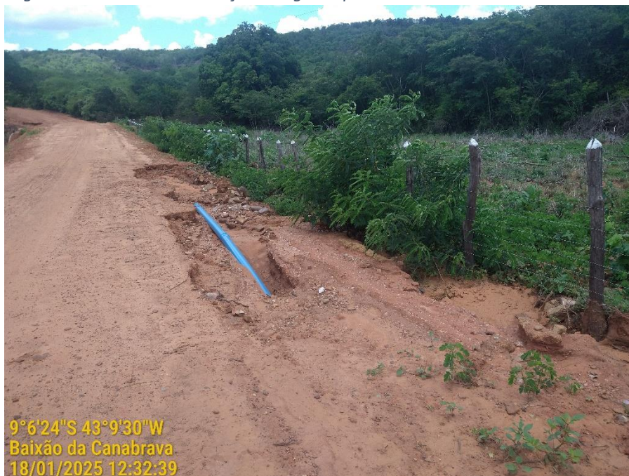
Figura 39 – Linha de distribuição de água exposta ao lado da estrada de acesso à ADA
