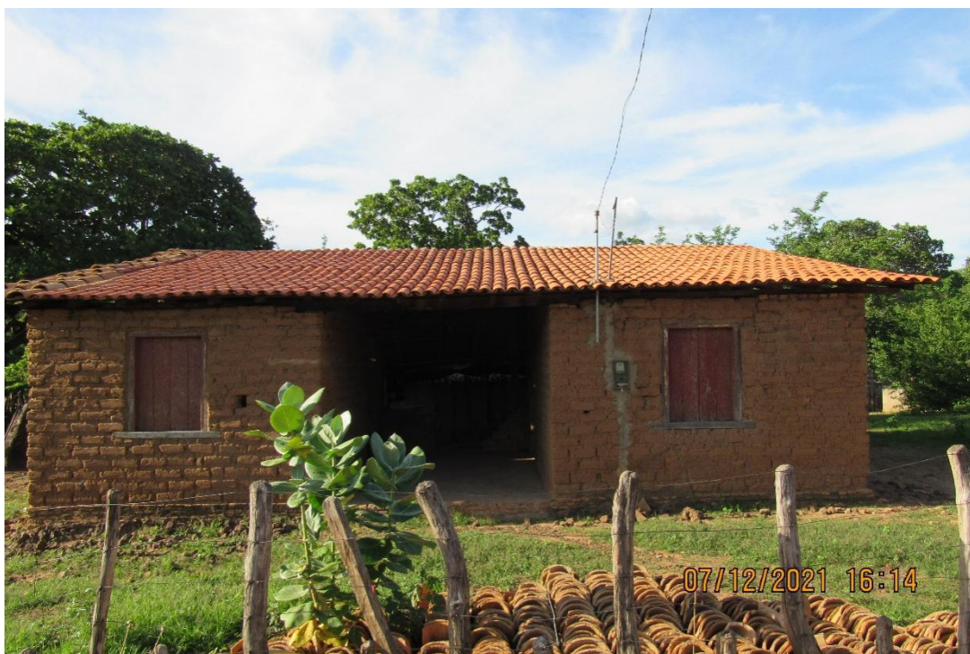
Figura 115. Casa sem o revestimento de reboco na área de abrangência da Fazenda Jerusa em Canavieira – PI.
