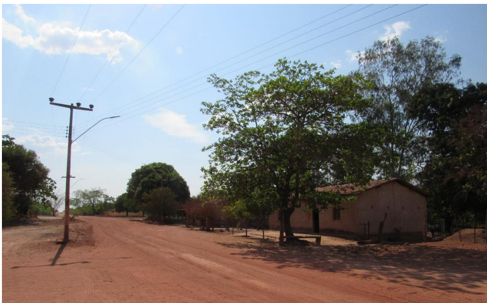
Figura 109. Serviço de distribuição de energia elétrica no povoado Pratinha em Uruçuí – PI.
