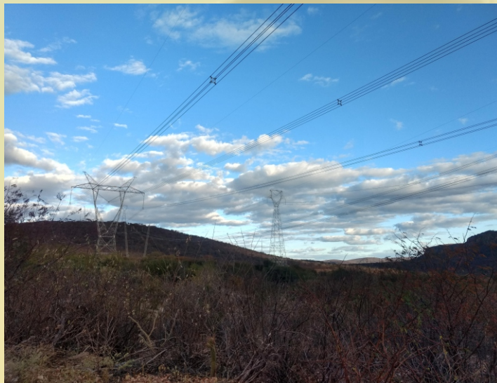
Linhas de Transmissão de Energia de Alta Tensão, Lagoa do Barro do Piauí (PI). Fonte: Biocore: 5/08/2020.
