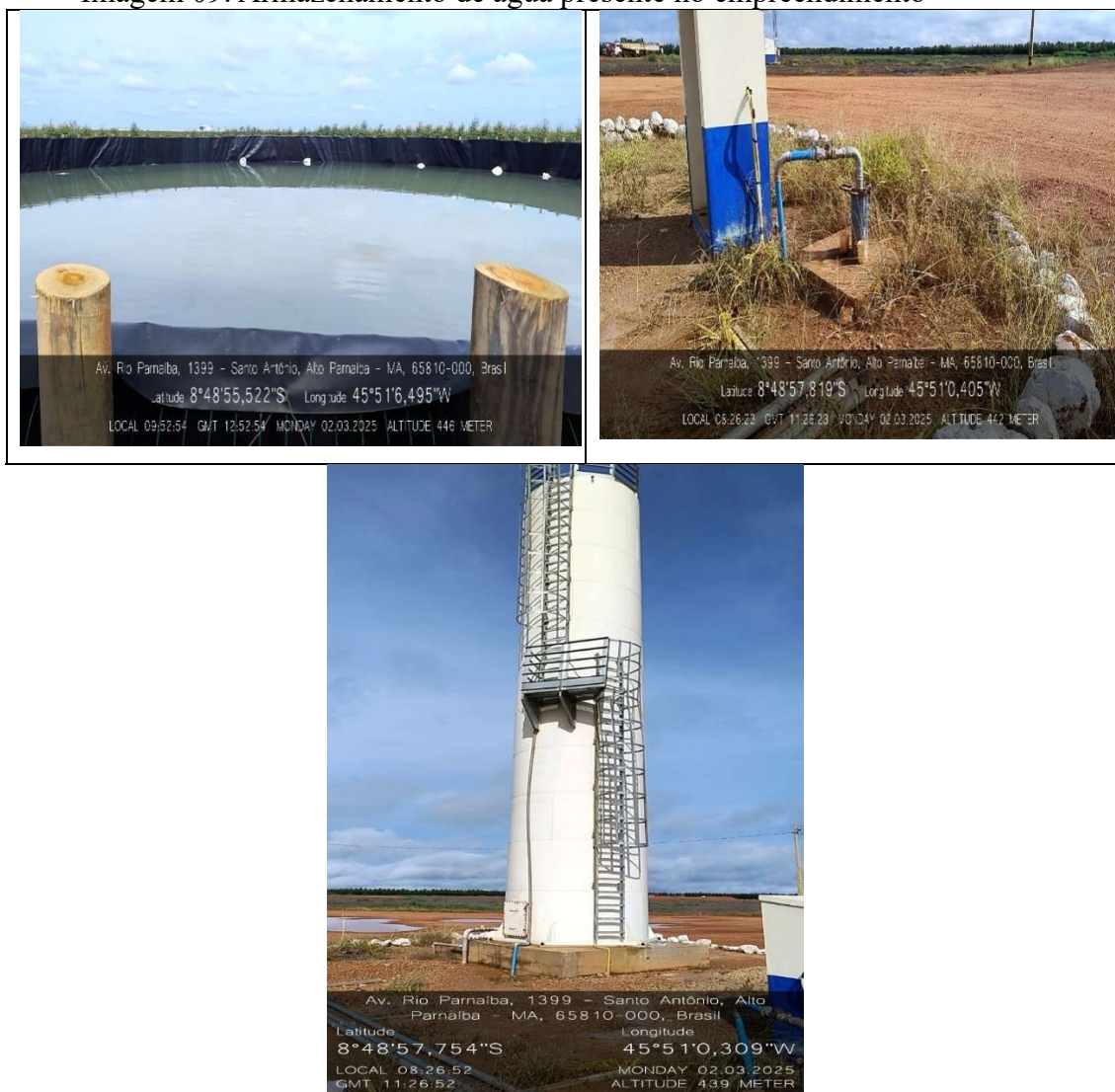
Imagem 09: Armazenamento de água presente no empreendimento
