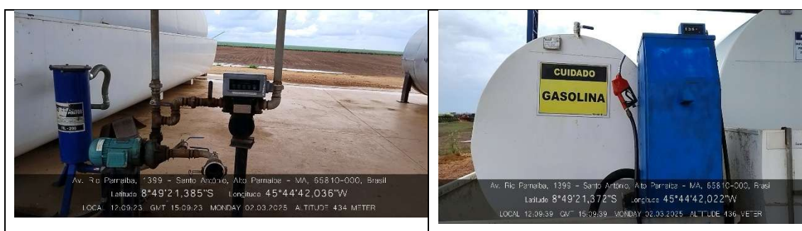
Imagem 10: Armazenamento de combustíveis na sede de apoio ao empreendimento
