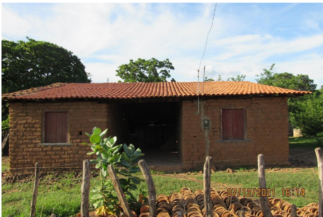
Figura 110. Casa sem o revestimento de reboco na área de abrangência da Fazenda Jerusa em Canavieira – PI.
