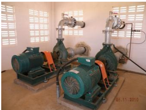
Foto 5-9 - Eletrobombas de pressurização do sistema.
