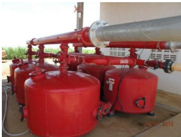
Foto 5-10 - Sistema de filtragem areia.
