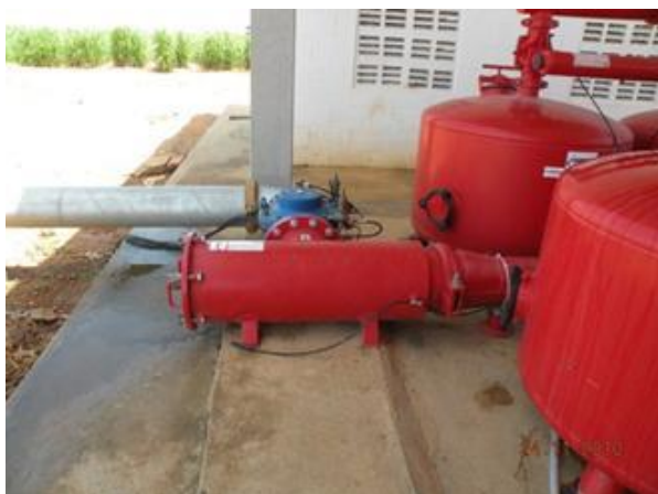
Foto 5-11 - Sistema de filtragem de segurança em tela.
