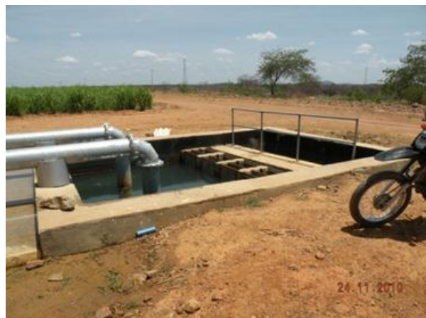
Foto 5-8 - Poço de sucção com pré-filtragem para bombeamento on farm.
