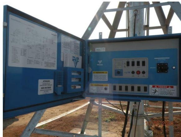
Foto 5-19 - Painel de comando do pivô central, instalado na torre central.
