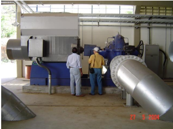
Foto 5-3 - Conjunto eletrobomba da EB elevatória.
