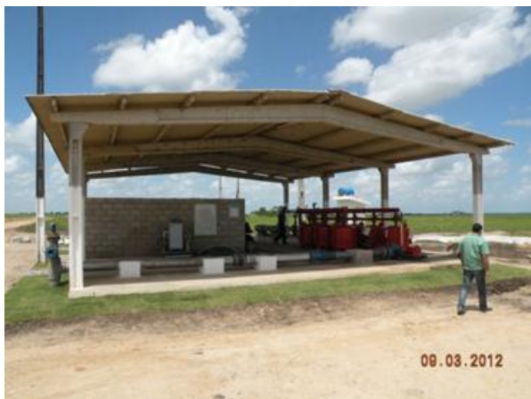
Foto 5-7 - EB, filtragem e quimigação em gotejamento.
