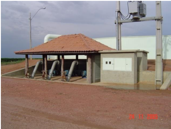
Foto 5-17- Estação de bombeamento para pivôs.
