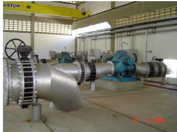
Foto 5-2 - Conjuntos eletrobombas da EB elevatória fixa e barriletes.
