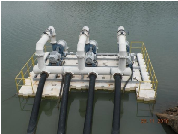
Foto 5-1 - Estação de Bombeamento (EB) elevatória flutuante.
