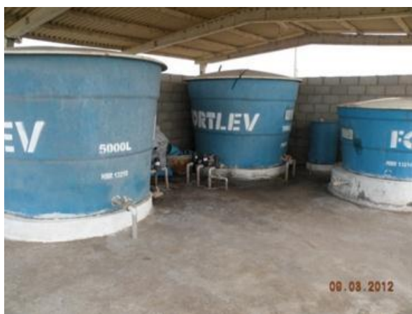
Foto 5-14 - Caixas com soluções nutritivas para injeção no sistema de quimigação.
