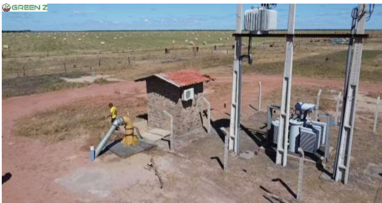
Figura 20. Estrutura para recepção e distribuição de energia elétrica para a Fazenda Vereda da Lagoa. (Coordenadas Geográficas da posição de sobrevoio da referida área com drone: -07,5418 S; -43,3517 O. Data da imagem: 15/11/2023).
