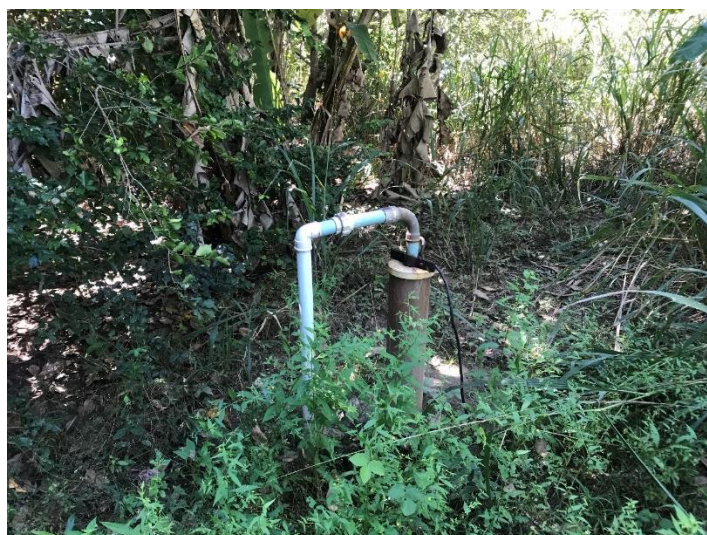
Figura 6-Poço tubular para abastecimento de água potável, nas dependências do empreendimento
