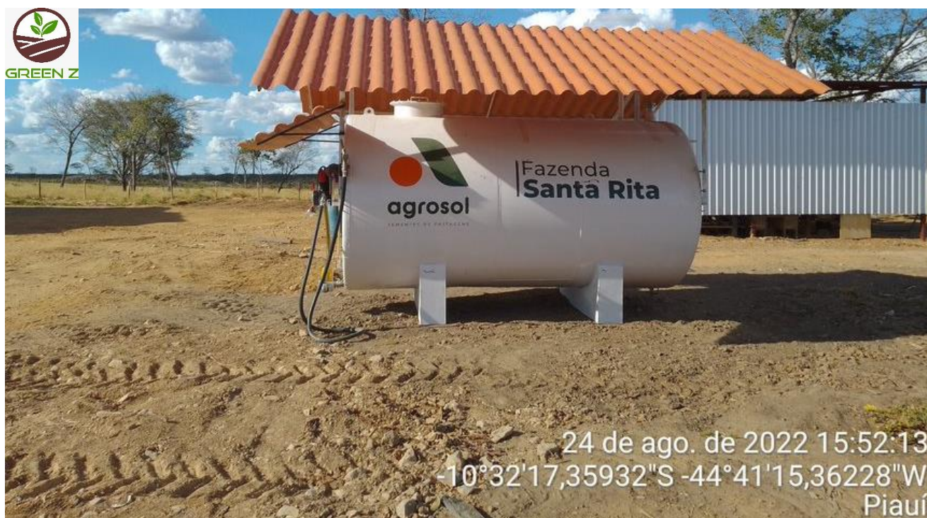
Figura 12. Tanque de combustível de 10.000 L de capacidade na Fazenda Santa Rita. Nota-se a estrutura fixa construída para instalação adequada no tanque.
