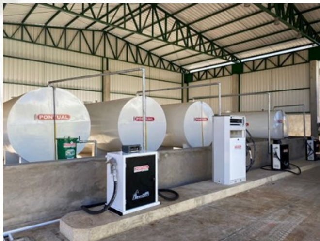
Foto 25 – Posto de Abastecimento de Combustíveis Sede Faz. Progresso (27/07/23)
