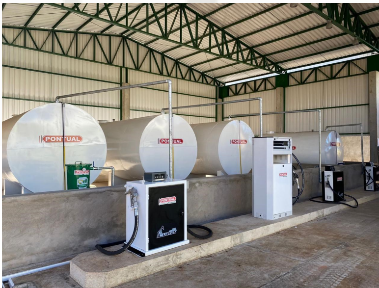
Foto 29 – Vista da sistema de abastecimento de combustíveis com tanques aéreos, instalados na sede da Fazenda Progresso, com toda a estrutura adequada e protegida, com sistemas de contenção de vazamentos.
