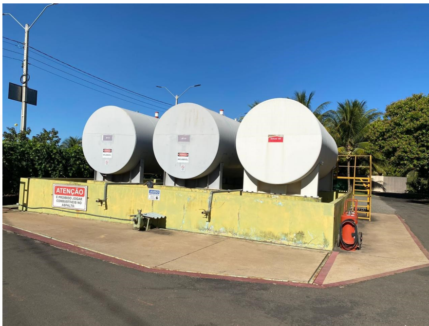
Foto 30 – Vista da sistema de abastecimento de combustíveis para aeronaves, com tanques aéreos, instalados na sede da Fazenda Progresso, com toda a estrutura adequada e protegida, com sistemas de contenção de vazamentos.
