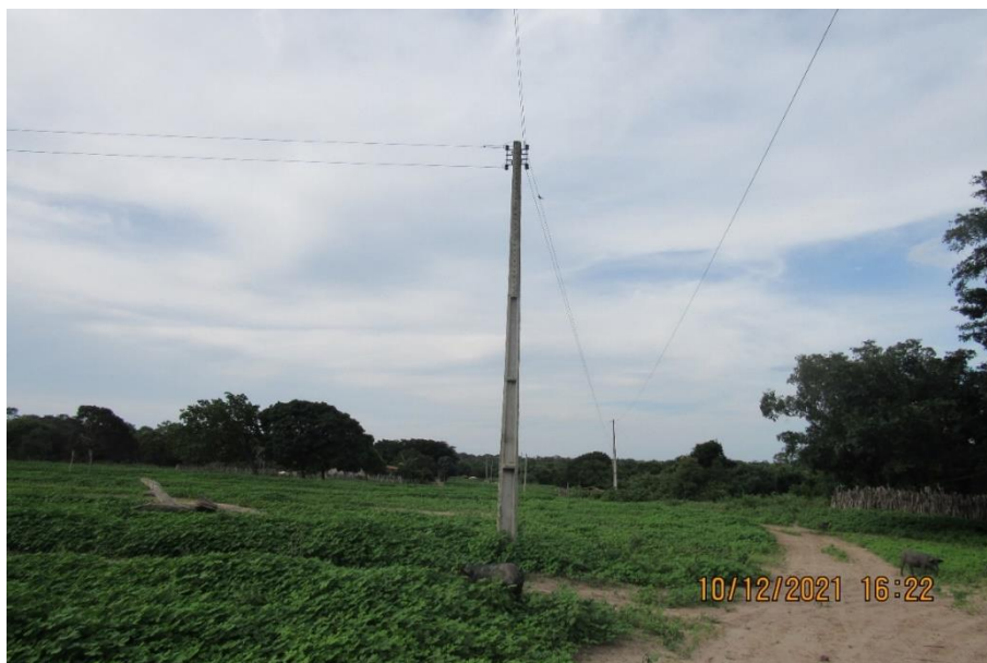
Figura 49. Serviço de distribuição de energia elétrica no Povoado Riachinho na área de abrangência da Fazenda Maravilha em Flores do Piauí – PI.
