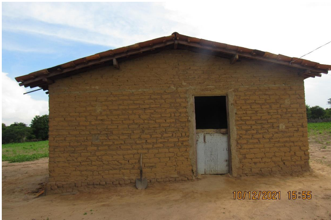
Figura 48. Moradia construída com adobe sem revestimento de cimento nas paredes e com piso de chão batido no Povoado Riachinho na área de abrangência da Fazenda Maravilha em Flores do Piauí – PI.
