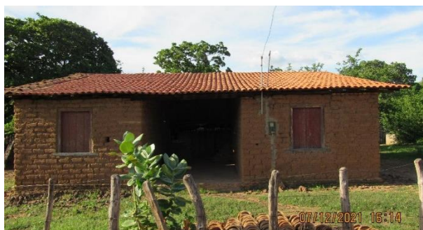
Figura 43. Casa sem o revestimento de reboco na área de abrangência da Fazenda Jerusa em Canavieira – PI.
