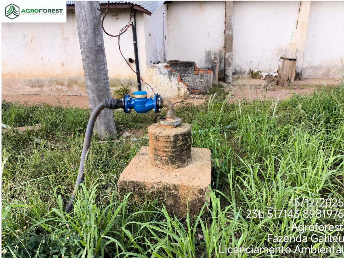
Figura 17. Poço artesiano da propriedade.
