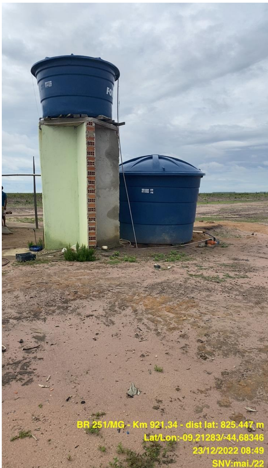
Foto 06 – Reservatório de armazenamento de água, comum aos Lotes, inclusive o Lote I
