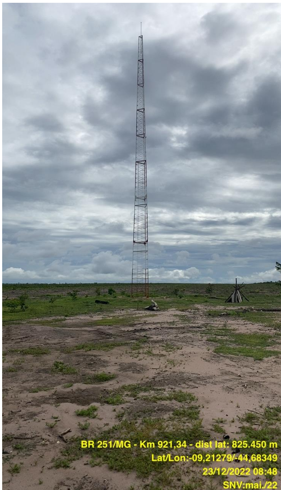
Foto 03 – Torre de comunicação de uso comum aos Lotes, inclusive o Lote I
