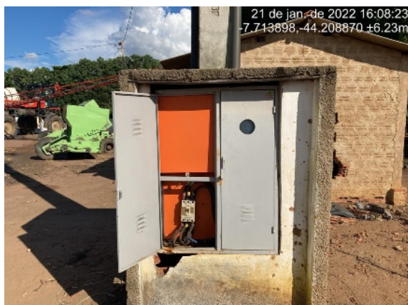
Quadro de energia
