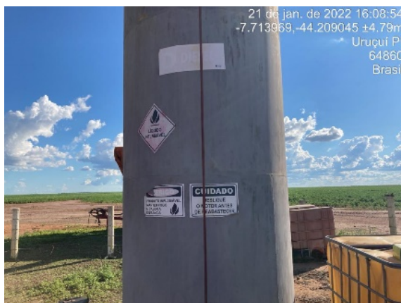
Detalhe bomba de óleo diesel
