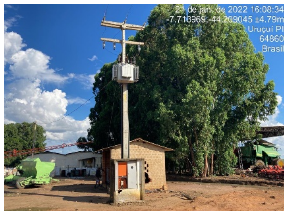
Poste de energia elétrica
