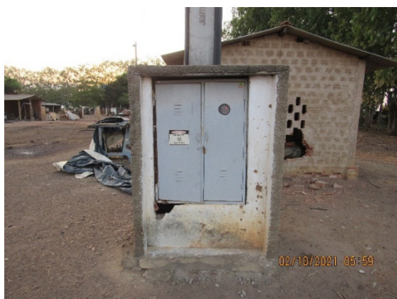
Figura 3. Quadro de energia.
