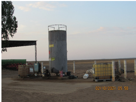
Bomba de óleo diesel de 5.000 litros
